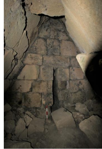
Fig. 7. A odası, güneyden kuzeye bakış, tahribat sonucu odanın tabanına düşen taş bloklar
